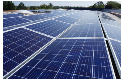
Der Strom für die Produktionsmaschinen, die Büro- und Lagerräume kommt künftig aus eigenem Hause.
